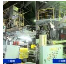
自動高圧造型ライン1号機・2号機
